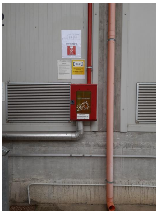
Valvola di apertura dell'impianto di allagamento della sala MACCHINE 2 con individuazione dello sgancio della corrente elettrica
