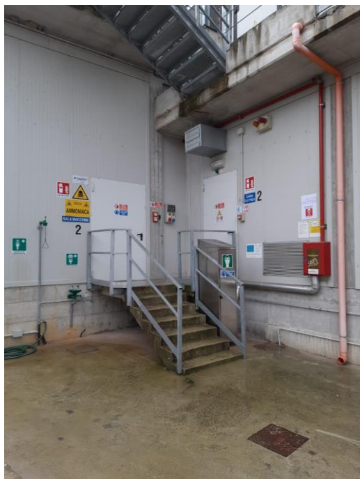
Panoramica generale della sala macchine 2
