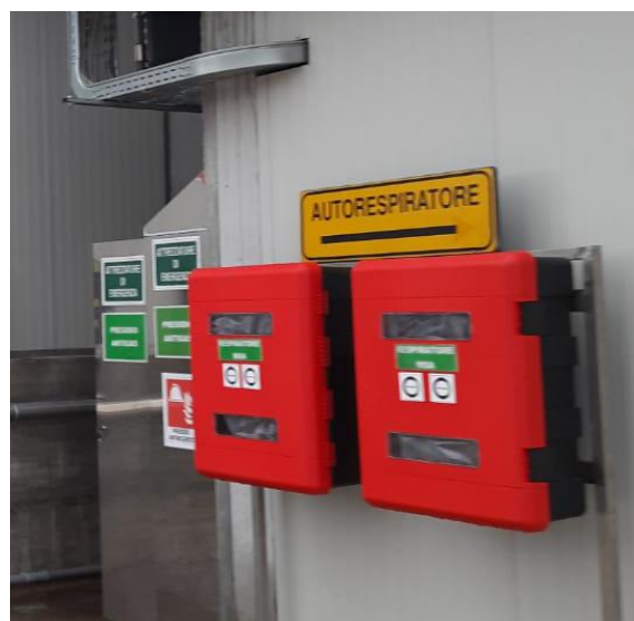
Cassette contenenti dispositivi di protezione per fughe da ammoniaca: tute antigas e autorespiratori
