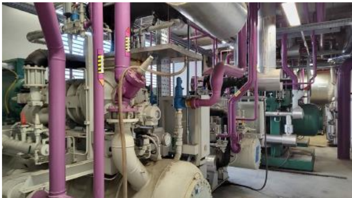
Panoramica sala macchina 3
